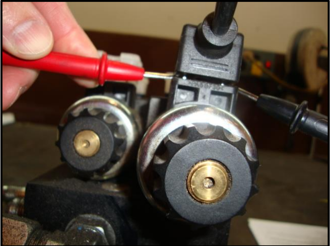
Fig. 8-2 Checking Din Plug Voltage
